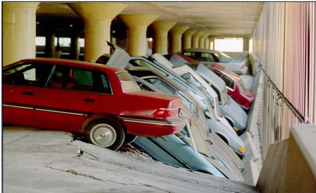
Effondrement d'un parking suite à la corrosion de ses armatures (USA)
