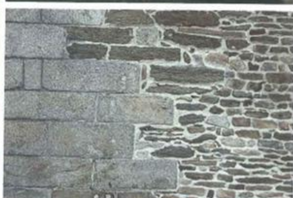
Association de pierres appareillées formant le chaînage de l'édifice et de moellons pour la maçonnerie courante
