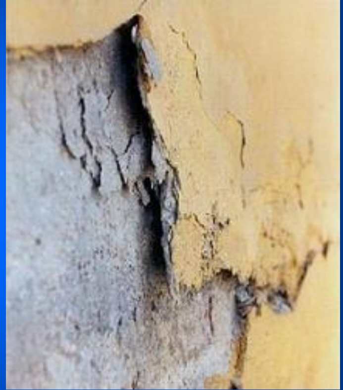
Exfoliation d'enduits, Lisbonne. Portugal
