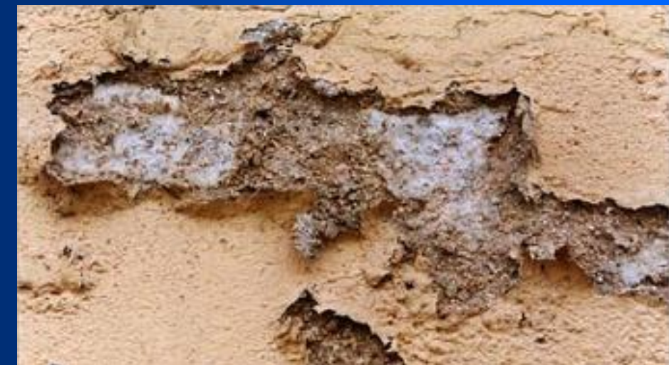
Efflorescence et pelage de peinture (Église, Coïmba, Portugal)
