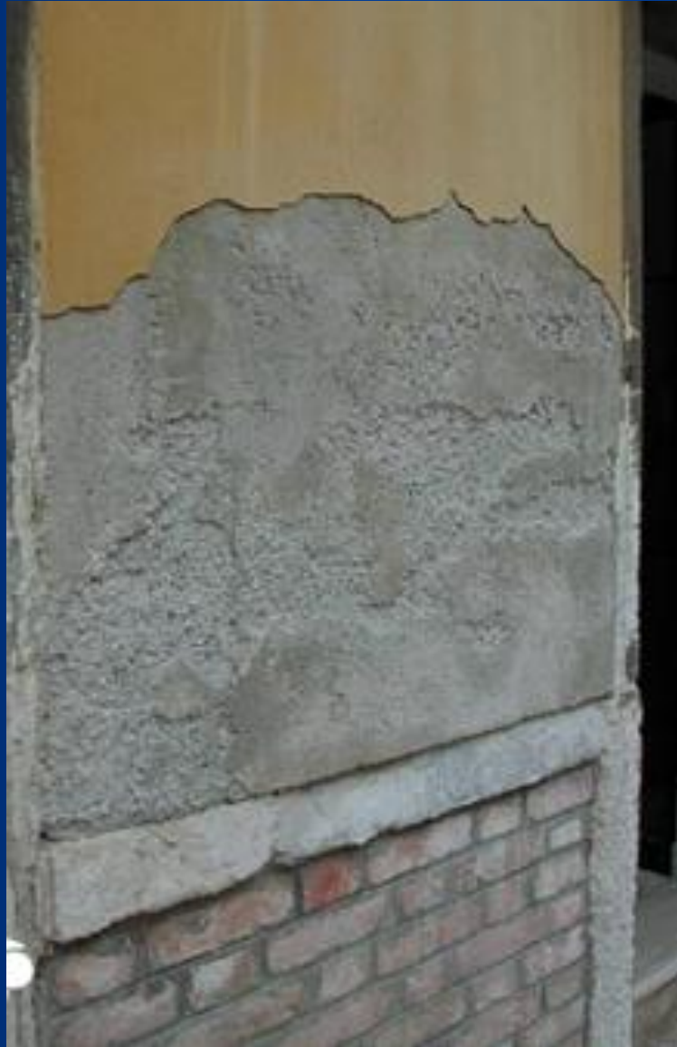
Délamination d'enduits, Coimbra, Portugal.
